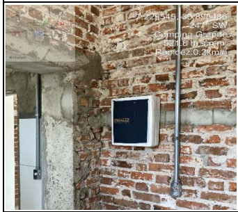
19.9.12.2 - Quadro de Distribuição
