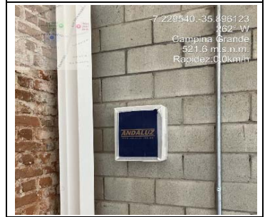
19.9.12.2 - Quadro de Distribuição
