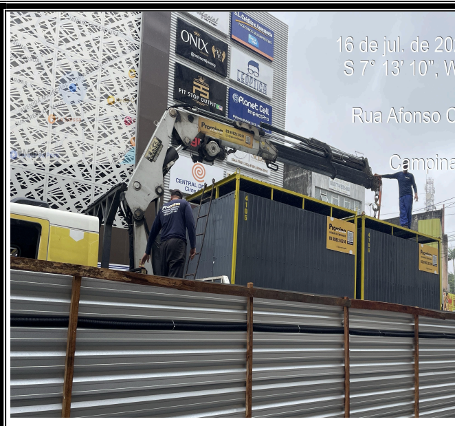
ITEM 1.1 (FASE 01) -LOCAÇÃO DE CONTAINER - BANHEIRO COM CHUVEIROS E VASOS - 4,30 X 2,30M -
