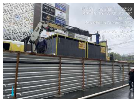
LOCAÇÃO DE CONTAINER - BANHEIRO COM CHUVEIROS E VASOS
