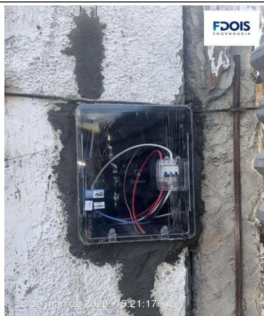
ENTRADA DE ENERGIA ELÉTRICA
