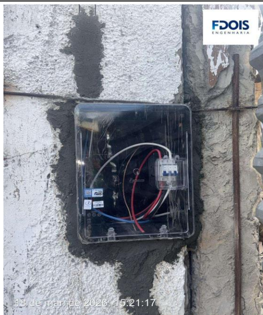
ENTRADA DE ENERGIA ELÉTRICA
