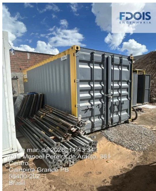
LOCAÇÃO DE CONTAINER - ALMOXARIFADO
