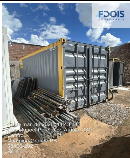
LOCAÇÃO DE CONTAINER - ALMOXARIFADO
