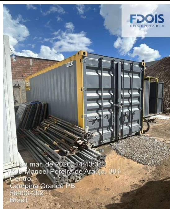
LOCAÇÃO DE CONTAINER - ALMOXARIFADO
