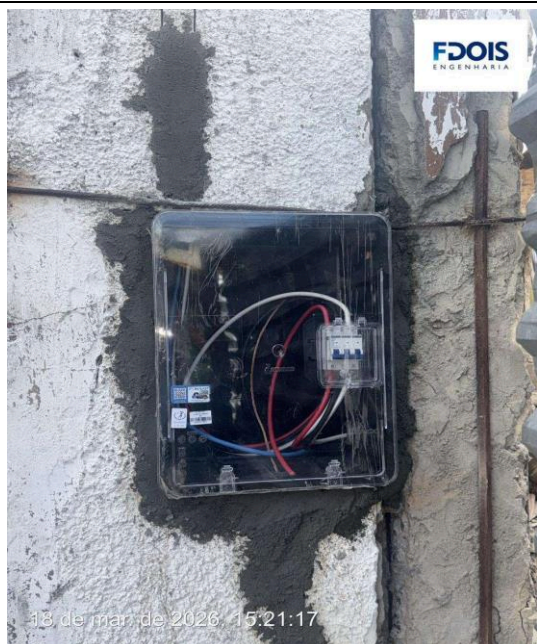
ENTRADA DE ENERGIA ELÉTRICA
