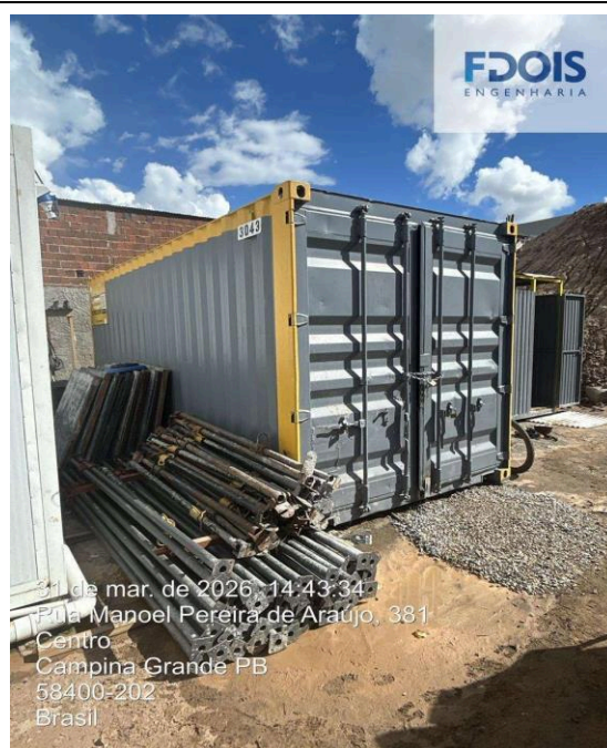
LOCAÇÃO DE CONTAINER - ALMOXARIFADO
