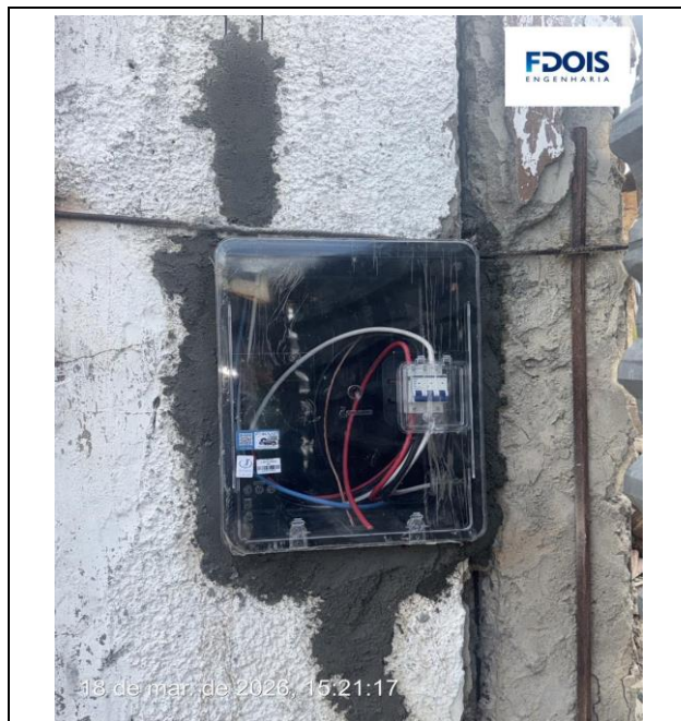
ENTRADA DE ENERGIA ELÉTRICA
