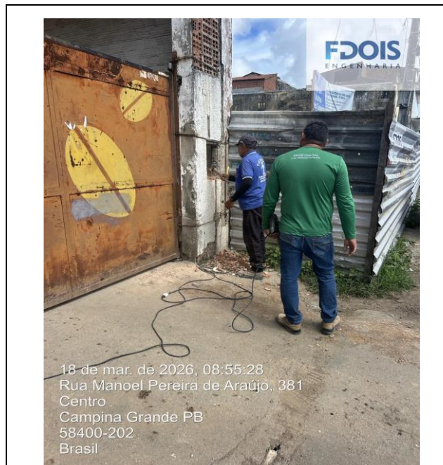
ENTRADA DE ENERGIA ELÉTRICA
