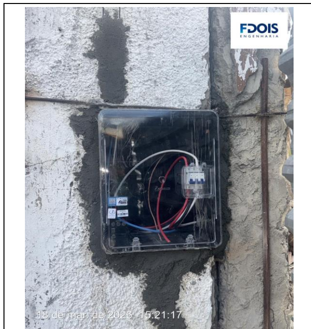
ENTRADA DE ENERGIA ELÉTRICA
