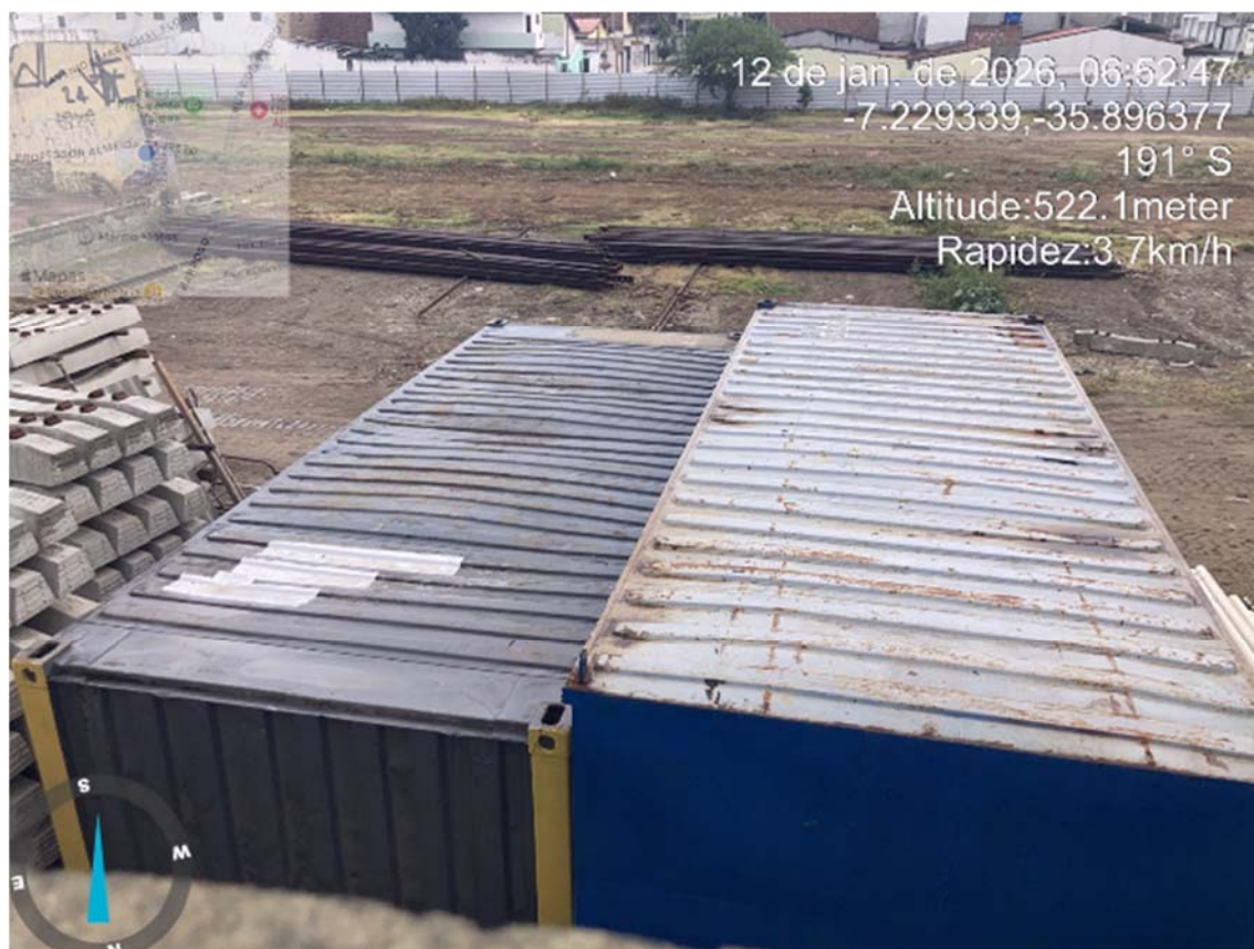
FOTO 01 CONTAINER - ALMOXARIFADO SEM BANHEIRO
