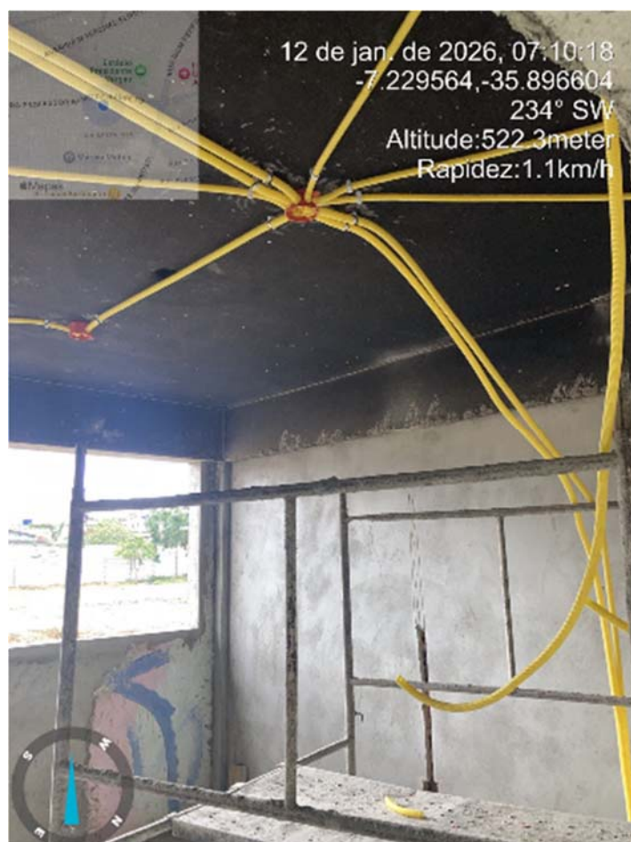
FOTO 05 – ELETRODUTO FLEXIVEL CORRUGADO
