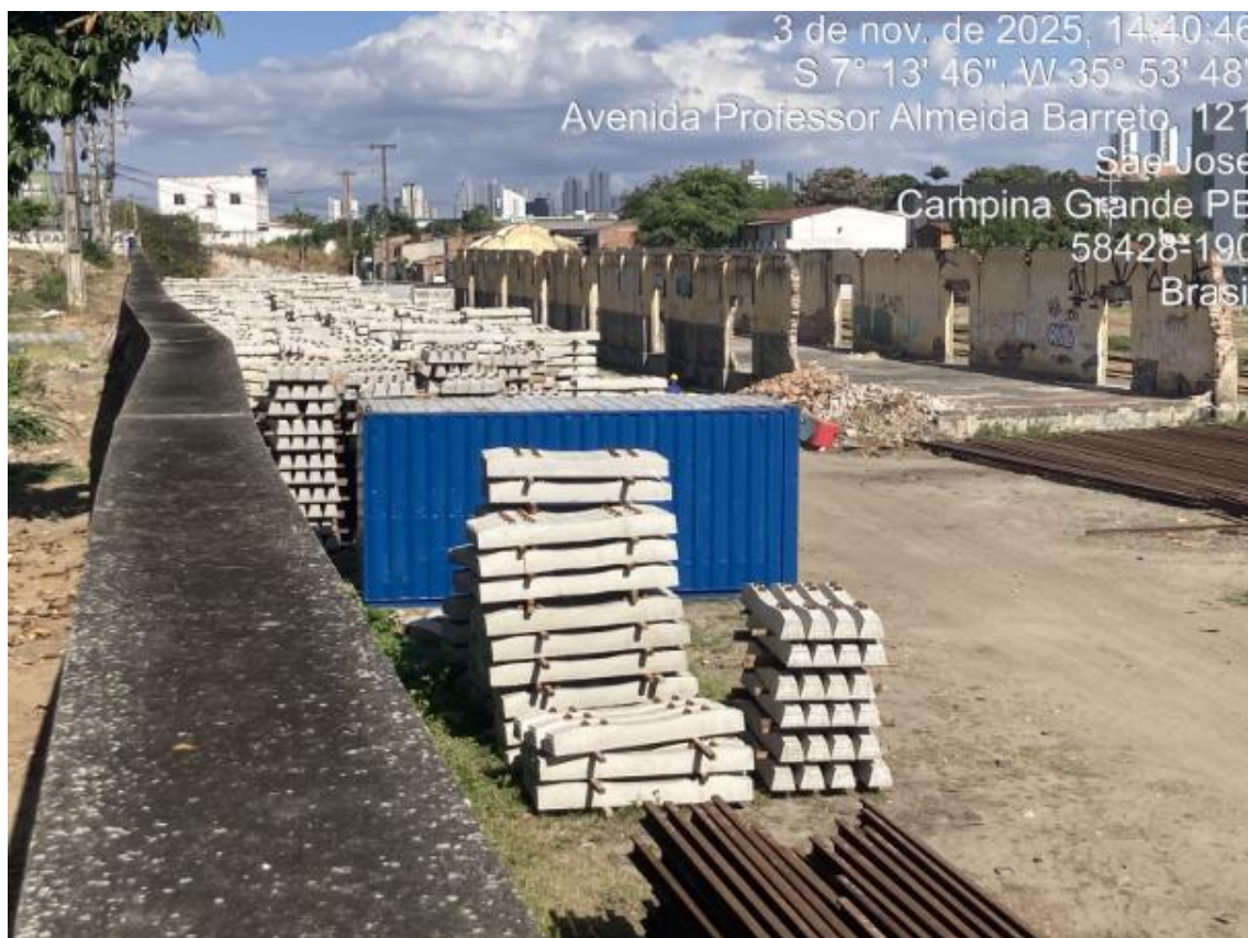
FOTO 08- CONTAINER - ALMOXARIFADO SEM BANHEIRO
