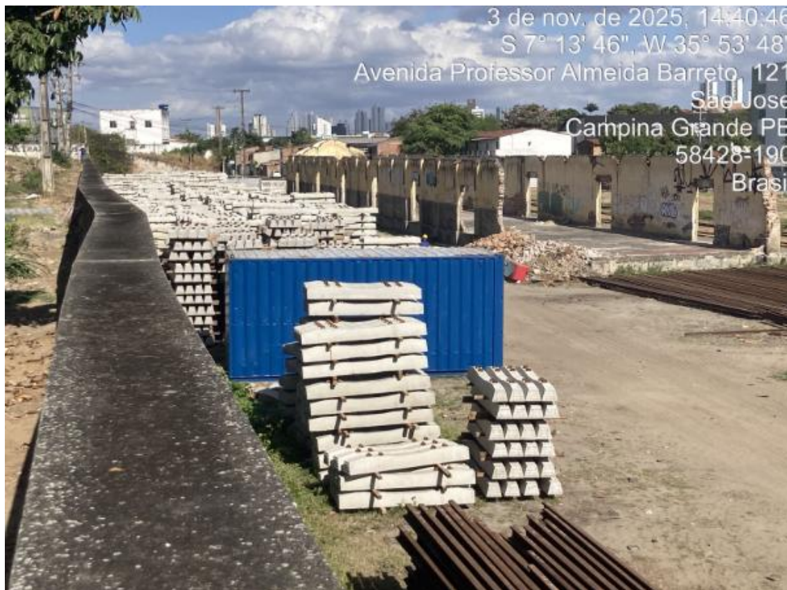
FOTO 08- CONTAINER - ALMOXARIFADO SEM BANHEIRO
