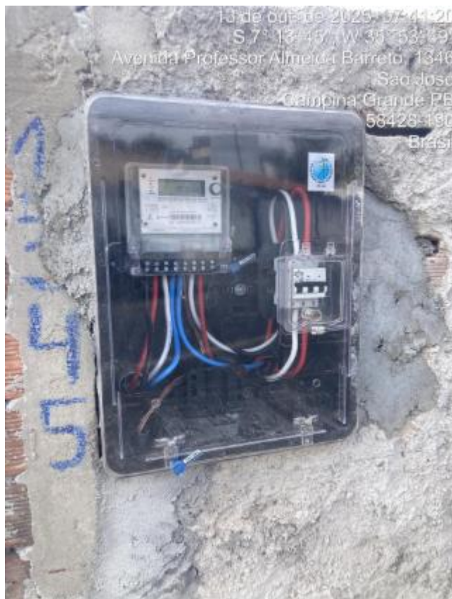
FOTO 08- INSTALAÇÃO PROVISÓRIA DE ENERGIA ELÉTRICA
