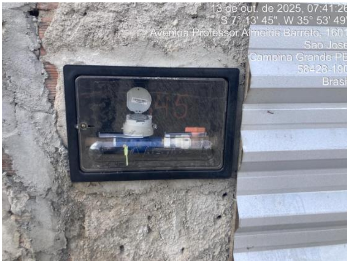
FOTO 07- LIGAÇÃO PREDIAL DE ÁGUA EM MURETA
