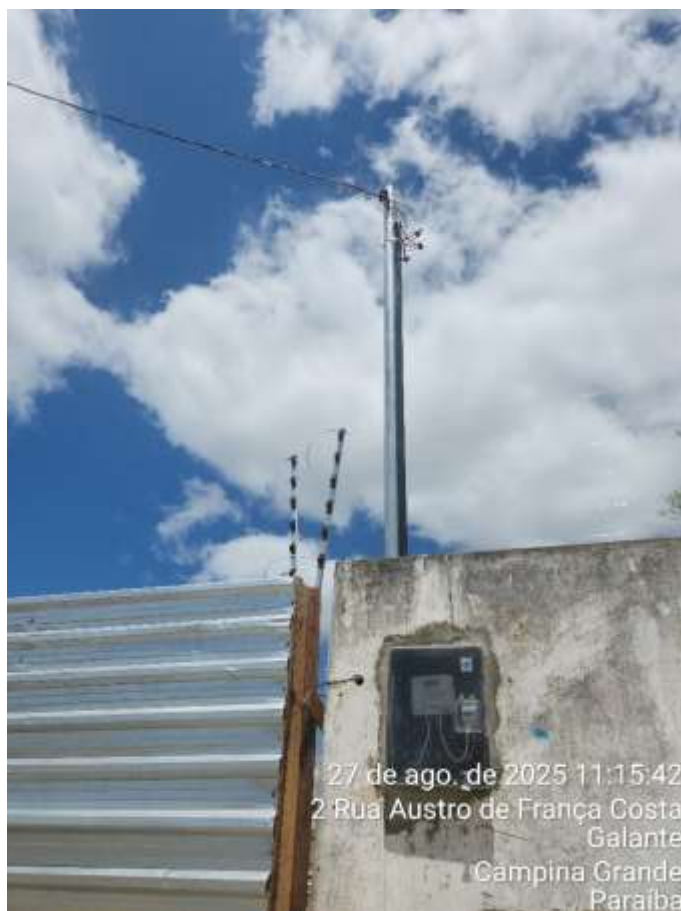
INSTALAÇÃO PROVISÓRIA DE ENERGIA ELÉTRICA
