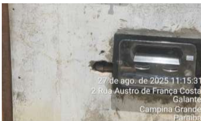
LIGAÇÃO PREDIAL DE ÁGUA EM MURETA
